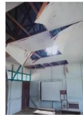
Gambar 5. Salah satu pojok ruang kelas di SDN 7 Lubuk Nibung yang butuh renovasi dan perbaikan total
